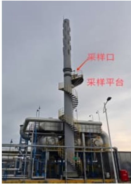
DA001 排气筒采样口及采样平台
