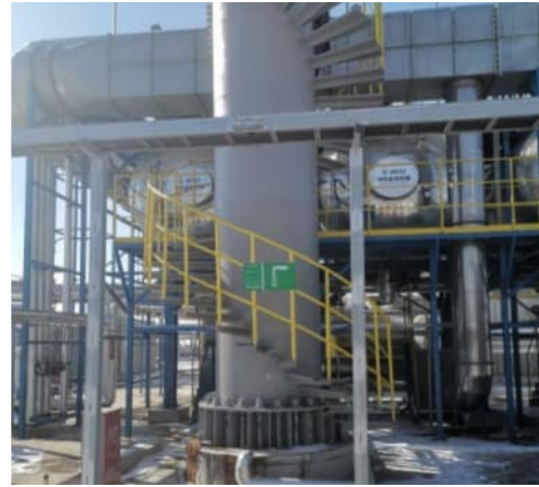
DA001 排气筒标志牌
