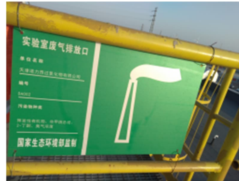
DA002 排气筒标志牌
